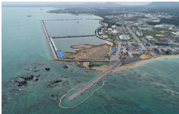
新基地建設作業が進む米軍キャンプ・シュワブ沿岸部。手前はN4護岸、名護市辺野古（小型無人機で撮影）2019.02.24（写真 沖縄タイムス社提供）
