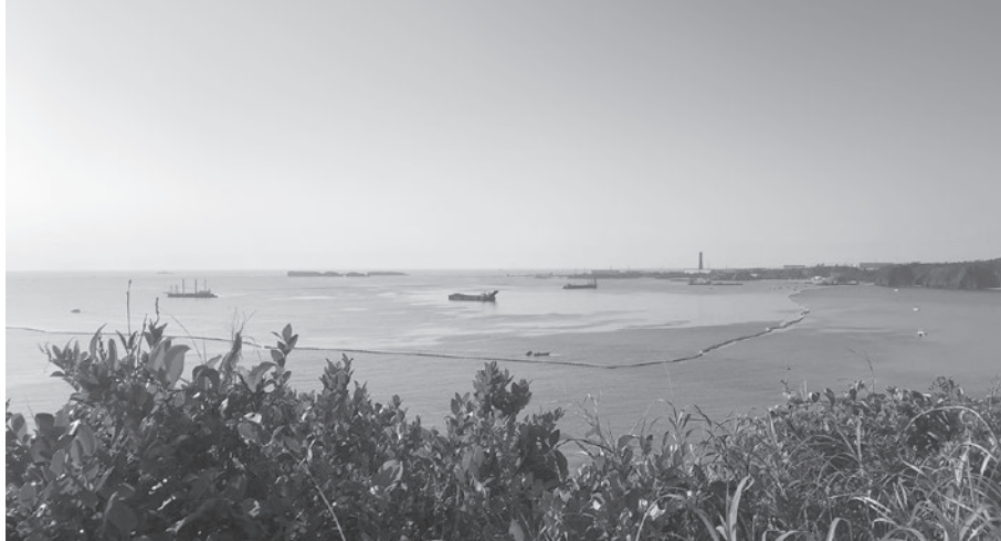
辺野古基地東側からの埋立状況。ブイの内側は立ち入り禁止になっており、ブイの外側（写真の右側）の白い船から埋立状況を監視している。
