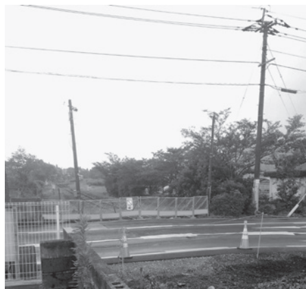
国道の不通により迂回路の通行量が増え、線路にアスファルトが敷かれた
